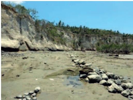
Pied de falaise reposant sur la plateforme d'abrasion, et enrochement de protection de la canalisation
