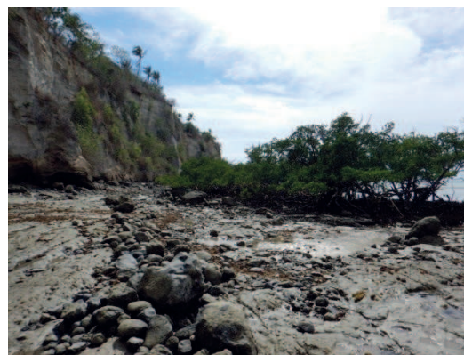
Enrochement de protection de la canalisation sur la plateforme d'abrasion, ilot NE de palétuvier
