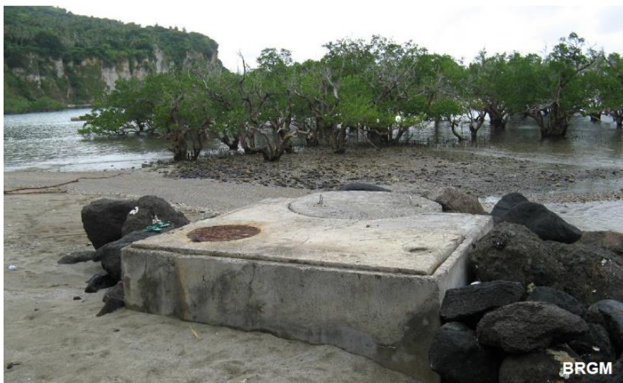
Figure 3 : Puit de pompage actuelle (source : BRGM/RP-57112FR 2009)
